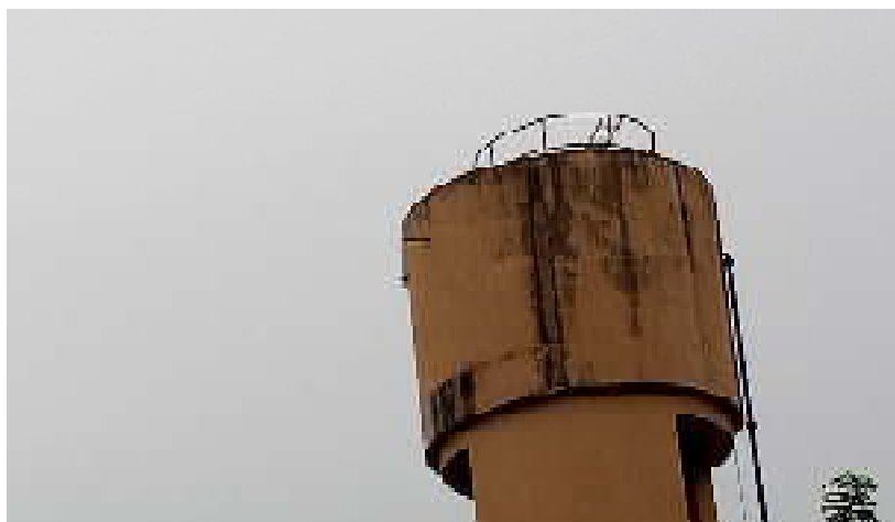
Photo VIII : Présence de fissures sur un château d'eau d'AEV dans le département (Juin, 2022)
