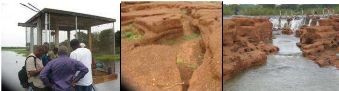
Photo 3 : quelques vues prises au barrage de l'Okpara montrant l'état défectueux de ce dernier
